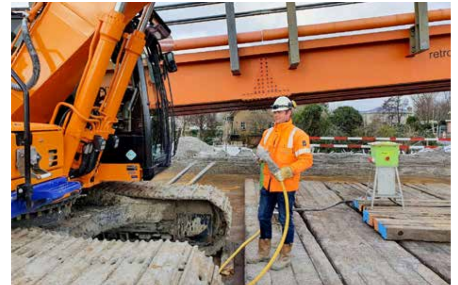
Een volledig elektrische 25 ton rups graafmachine op de bouwplaats van De Groene Boog.
